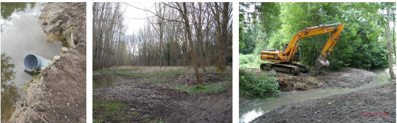
Photo 7 - Exemple de travaux de restauration hydraulique d'une zone humide, de gauche à droite : installation d'une prise d'eau, création d'un brèche et arasement d'un merlon
