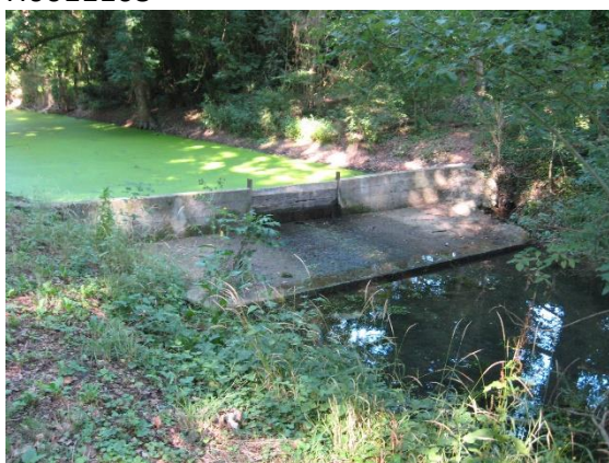
Ouvrage du bourg d'Escrennes à supprimer
